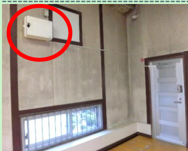
写真左: システムボックス
