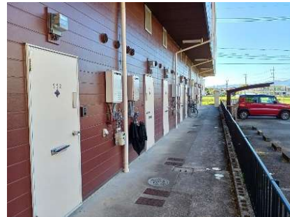
【マイロック設置写真】 全部屋にマイロックを設置致しました。
