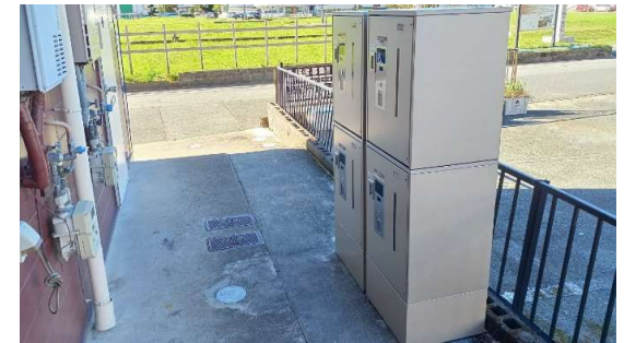
【宅配ボックス設置写真】
