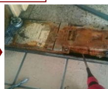
フタを外して中を見ると、サビによる腐食がかなり進んでいました。
