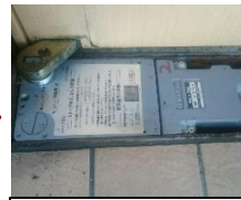
新しい物と交換し、設置完了。入居者も物件担当者様もこれで安心です。
